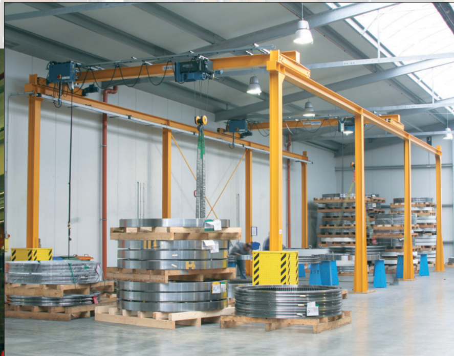
Frei stehende Portalkrananlage mit zwei 3,2 t Laufkränen
