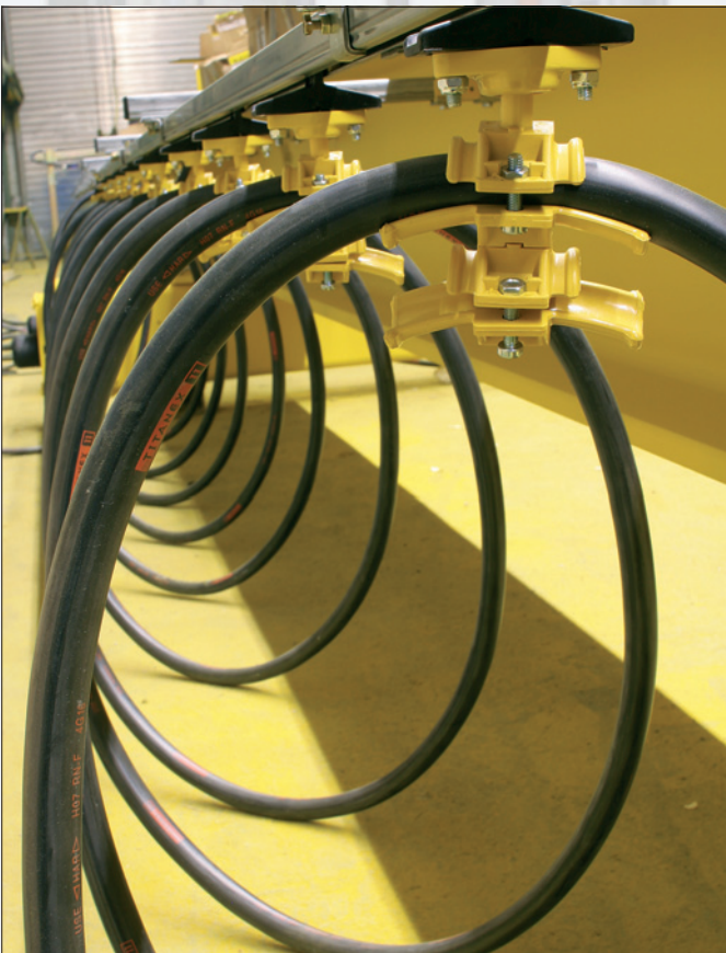
Hauptstromzuführung für Ex-Kran in Sonderausführung
