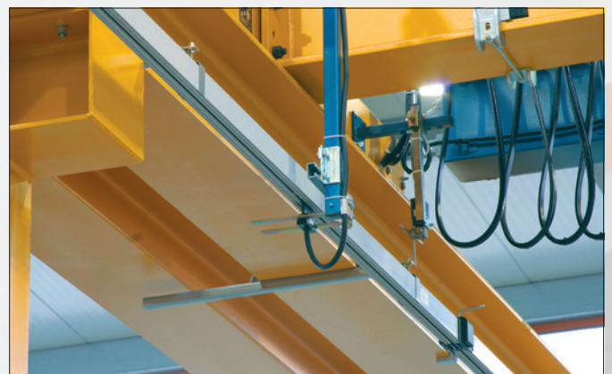
Standard-Hauptstromzuführung mit Schleifleitung
